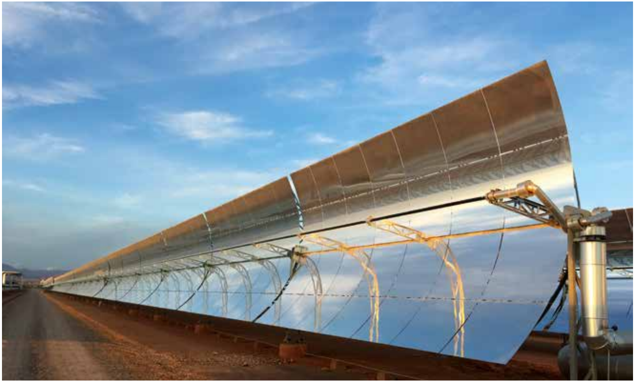
Über eine halbe Million Parabolspiegel gehören zum Kraftwerk Noor in der Nähe von Ouarzazate in der marokkanischen Wüste. Marokko wird zunehmend zum Vorreiter für Erneuerbare Energien.
